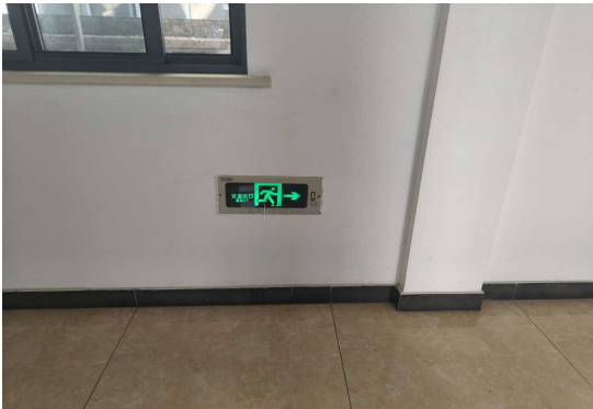
Emergency exit-signage 紧急出口指示牌
