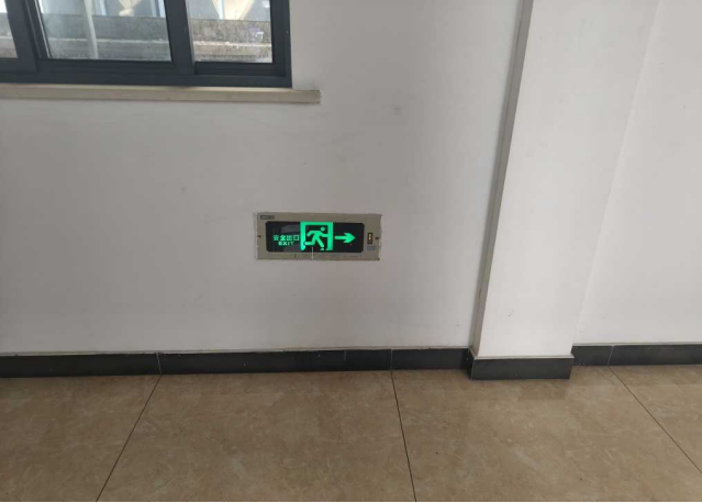
Emergency exit-signage 紧急出口指示牌
